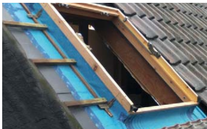
Ook het dakraam dient luchtdicht te worden gemaakt. (foto MilieuAdviesWinkel)
